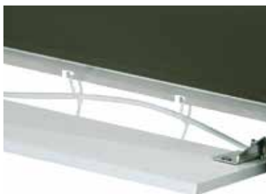
Короб для электропроводки
